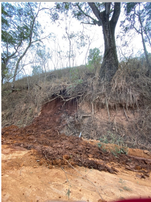
- Desmoronamento de encosta no trecho;
