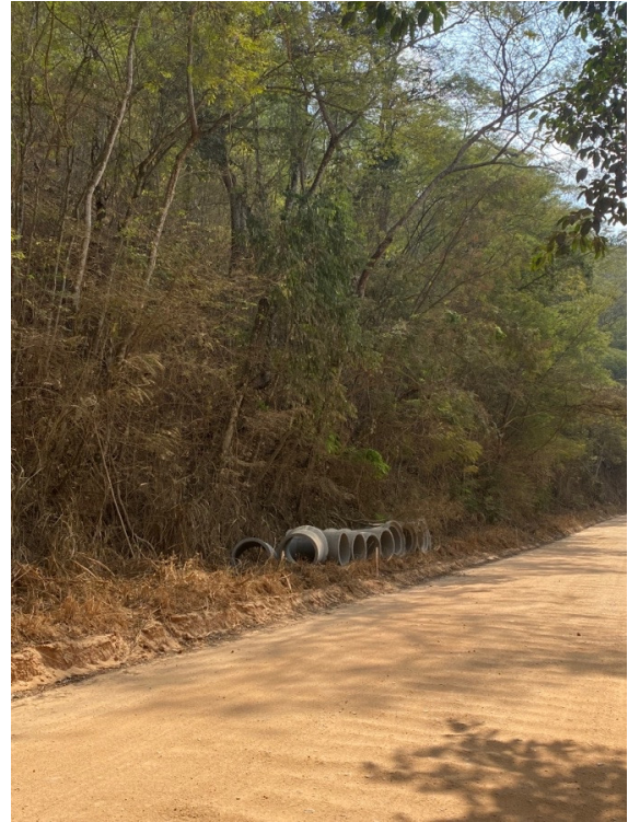
- CHEGADA DE MANILHAS E DISTRIBUIÇÃO DAS MESMAS NOS PONTOS DESTINADOS À UTILIZAÇÃO;
